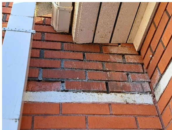
Kuva 36. Teknisen työn päädyssä on jäätyksen aiheuttamaa rapaumaa.
