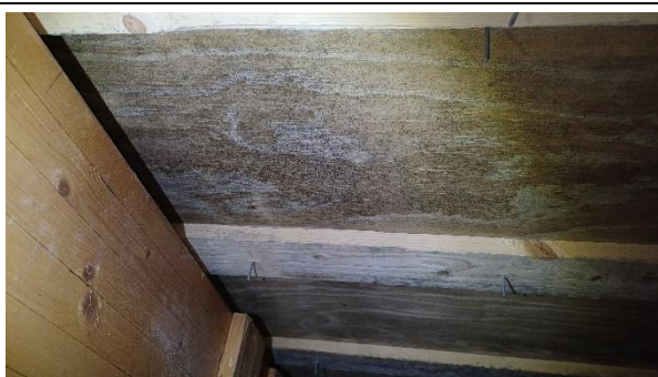
Kuva 49. Teknisen työn tilan yläpuolella olevassa yläpohjatilassa puurakenteissa silminnähtävää tummentumaa/mikrobikasvustoa
