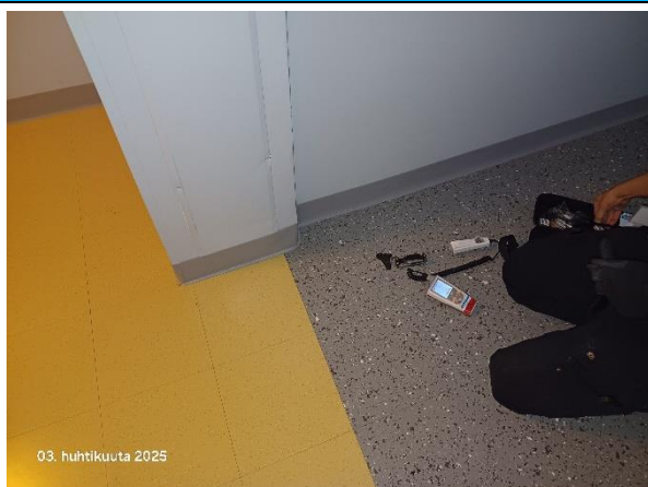
Kuva 25. Matalan osan käytävä, viiltokosteusmittaus pinnoitteen alta.
