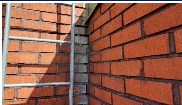
Kuva 42. Piipun ja liikuntasalin ulkoseinässä jäätymisen aiheuttamaa rapaamaa.
