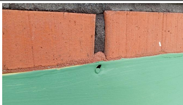
Kuva 40. Pellityksen ja sauman massauksissa on epätiiveyksiä.
