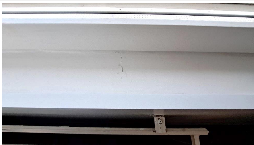
Musiikkiluokan ikkunapenkeissä halkeamia.
