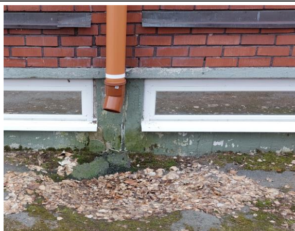
Kuva 8. Sadevesikaivo tukossa, sokkelissa kasvaa sammalta.
