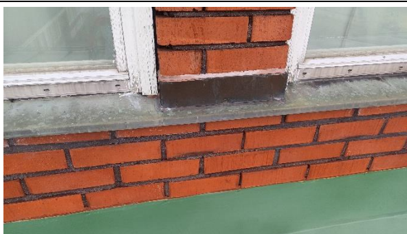
Kuva 39. Liikuntasalin ruokalan puoleiset ulkoseinän tiilisaumat huonokuntoisia.
