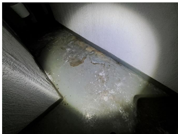
Kuva 17. Kellarissa siellä täällä kosteusjälkiä.
