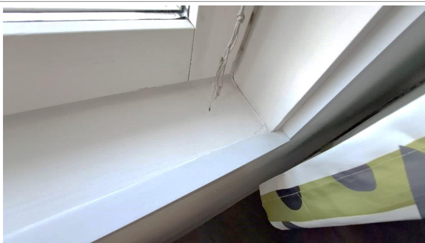
Musiikkiluokan ikkunapenkeissä halkeamia.
