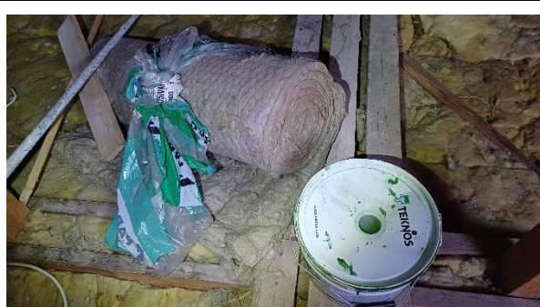
Kuva 58. Liikuntasalin yläpuolisessa yläpohjatilassa sinne kuulumatonta rakennusjätettä
