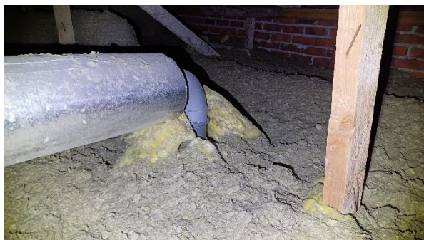
Kuva 55. Ruokalan yläpuolisessa yläpohjatilassa viemärin tuuletusputki lämmöneristetty puutteellisesti
