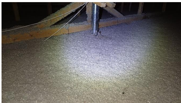
Kuva 53. Luukkasiiven antennin jalan kohdalla pieni kosteusvaurioalue
