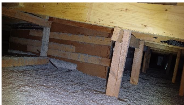
Kuva 51. Luokkasiiven yläpohjatilassa kattoikkunan rakenteissa vesivuotojälkiä
