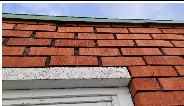
Kuva 37. Liikuntasalin ruokalan puoleiset ulkoseinän tiilisaumat huonokuntoisia.
